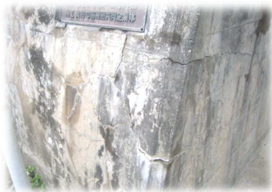
抗門面壁のひび割れ
