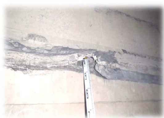
壁面打継部の剥離
