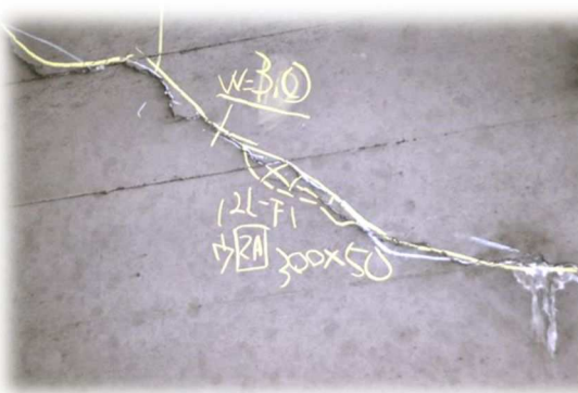
覆工アーチ部のひび割れ
