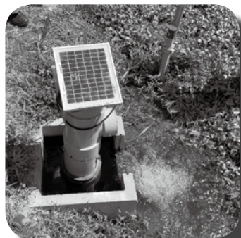
<スマートフォン操作による自動給水システム>
